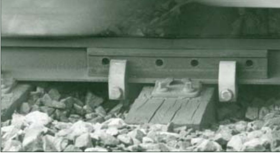
Maarn: spoorspalk (inmiddels hersteld).
